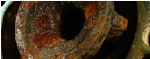
18/11 AM - Schade en Corrosie
